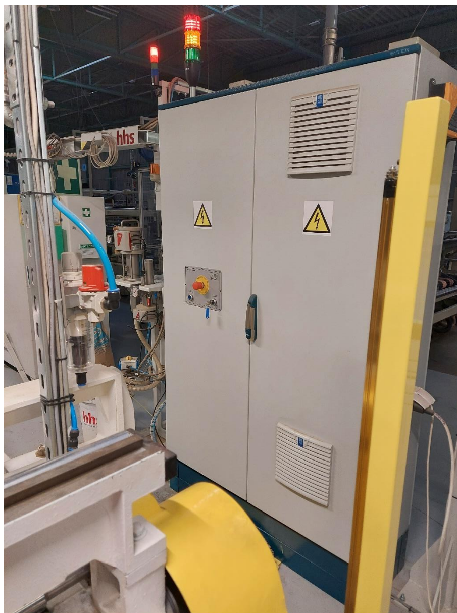
Zdjęcie 2 Widok szafy głównej i kurtyny bezpieczeństwa
