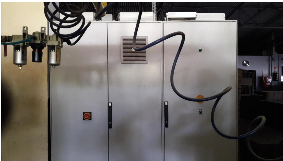
Zdjęcie 2. Widok elewacji szafy sterowniczej.
