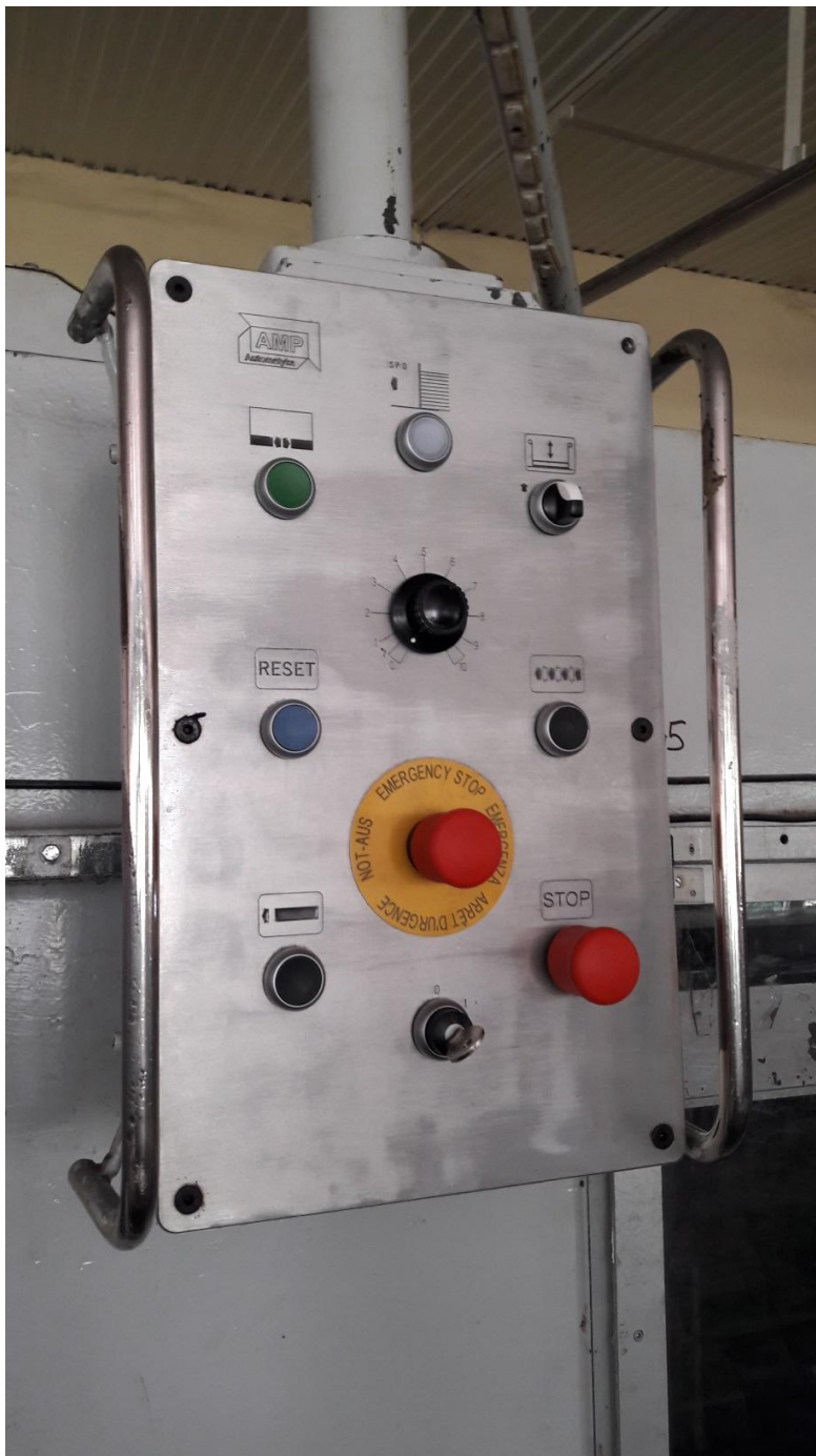
Zdjęcie 5. Widok panela operatorskiego.
