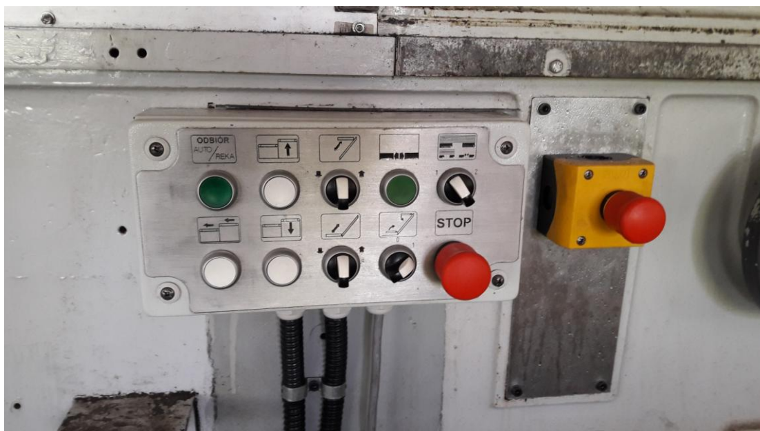
Zdjęcie 6. Widok panela obsługującego wyrzutnik formatu i windę.
