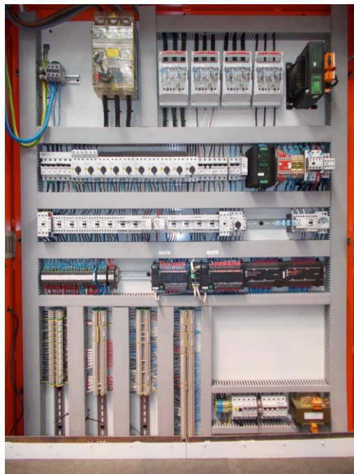
Zdjęcie 1 Widok szafy sterowniczej.
