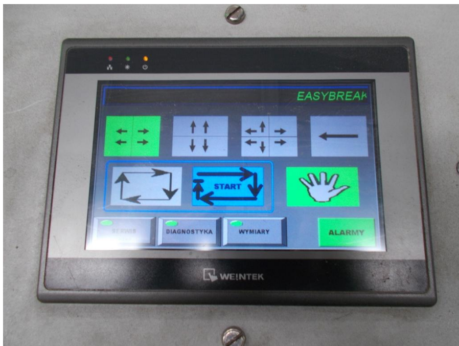
Zdjęcie 5 Widok panela operatorskiego – wybór trybów pracy.
